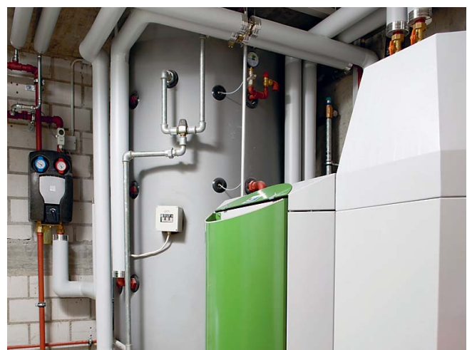
La chaudière à pellets de la maison Reist
